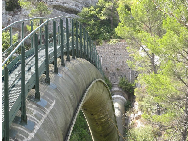
Siphon de l'Arc
