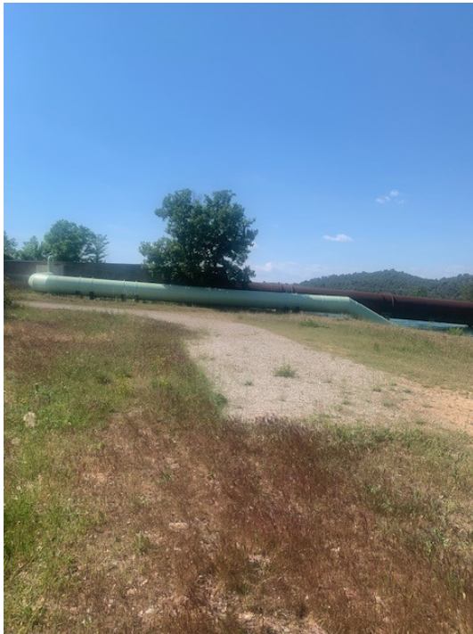
Sortie récente sur le siphon permettant d'alimenter le canal pendant période de travaux
