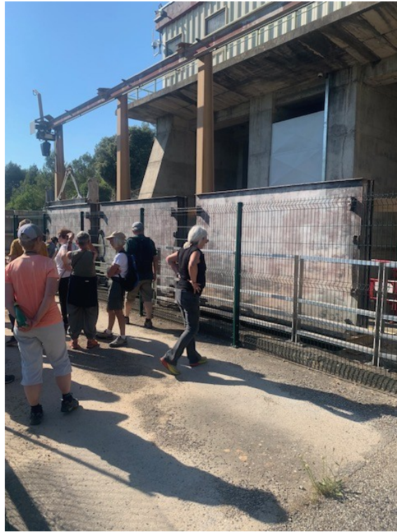
Sortie eau alimentation du canal
